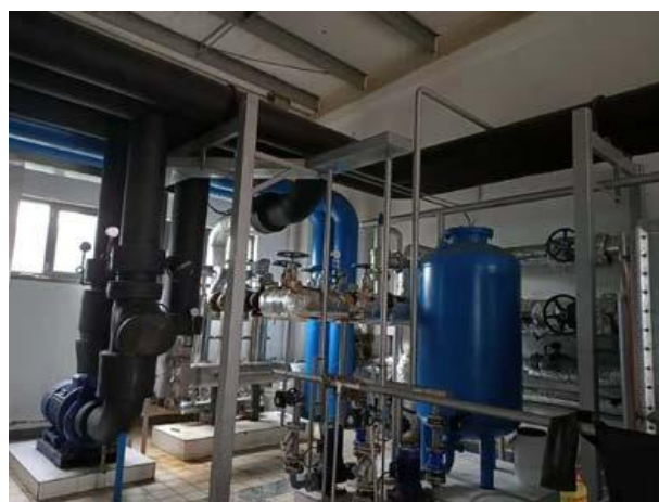
冷热空调送风系统
