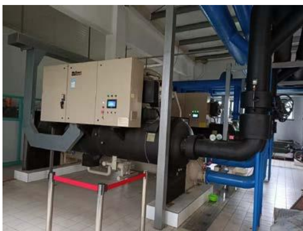
冷热空调送风系统
