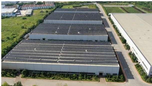
光伏发电设施
