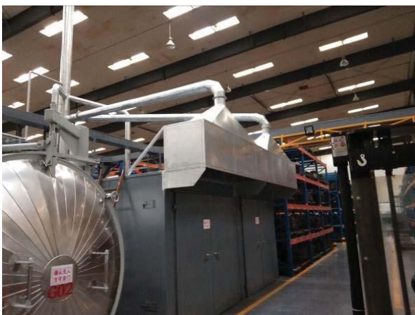
机台废气抽风装置
