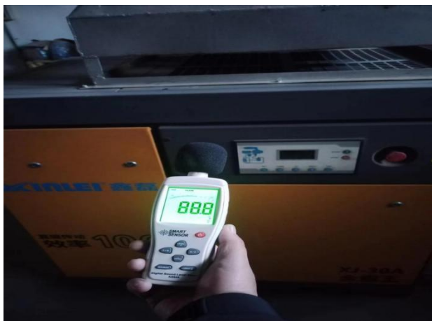
空压机安装在物理设施内-内部噪音检测
