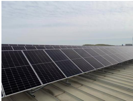
光伏发电设施
